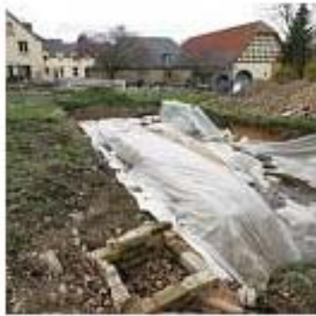
Mit Planen abgedeckt sind Fundamente der einstigen Klosteranlage. Seit Dienstag hat der Umbau des Klostergeländes Heisterbach begonnen. (Bild: Klodt)
